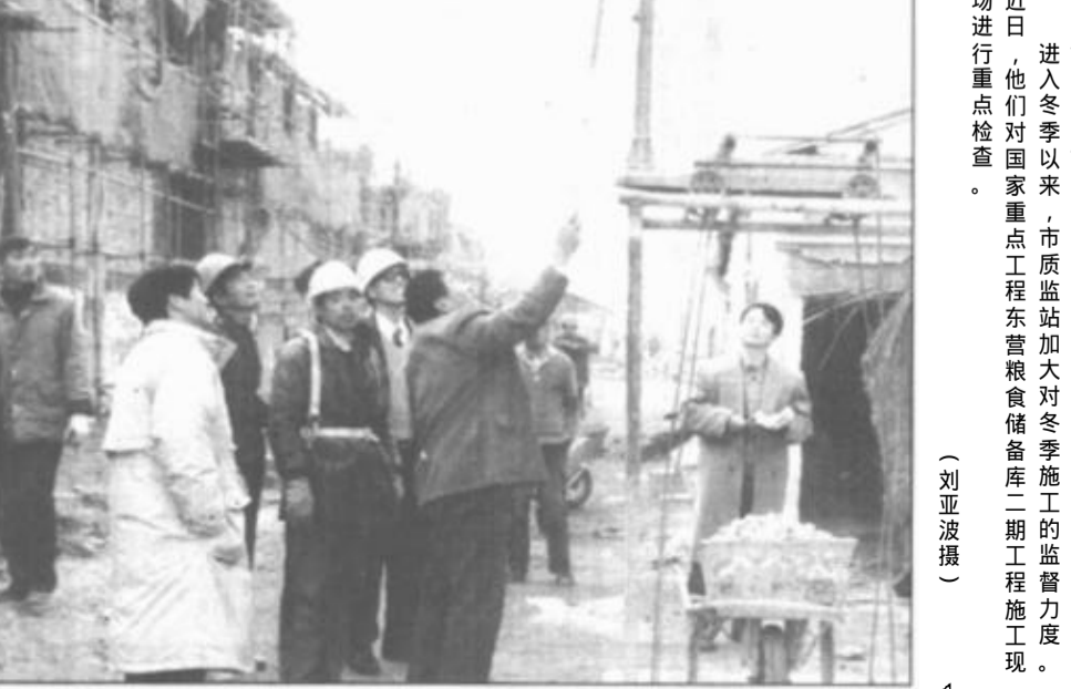
近日，他们对国家重点工程东营粮食储备库二期工程施工现场进行重点检查。（刘亚波摄）
